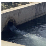
A água chegando das bombas da represa nos tanques de tranquilização adiante
