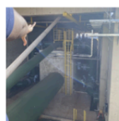
Tubulações que levam a água aos reservatórios
