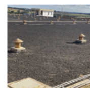
Poço de contato (chaminés para prevenir possíveis explosões)
