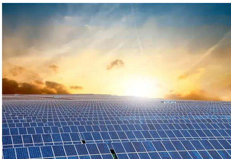
Figura 1 - Placas Solares. Fonte: energia fotovoltaica - Portal Solar
